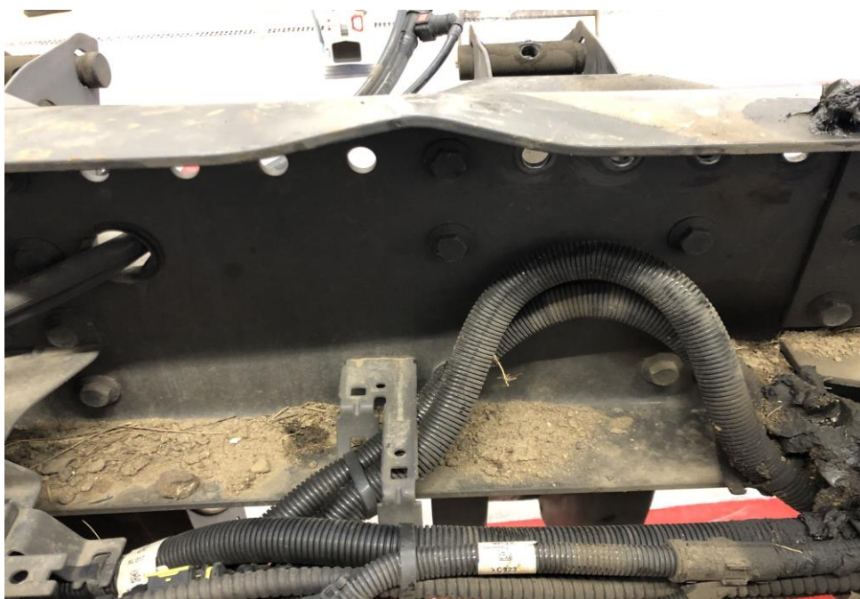
Josam - poškození rámu před rovnáním
